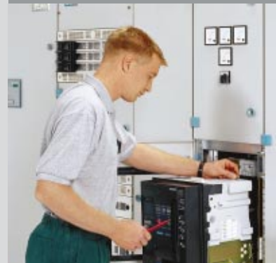
3WL w położeniu remontowym; przegląd bez wyjmowania wyłącznika
